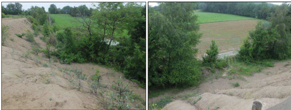
Figure 117 – Vues du ravinement des résidus sur le flanc sud-est de la « digue » n°2 (à droite) et sur le flanc sud (à gauche) (septembre 2018)
