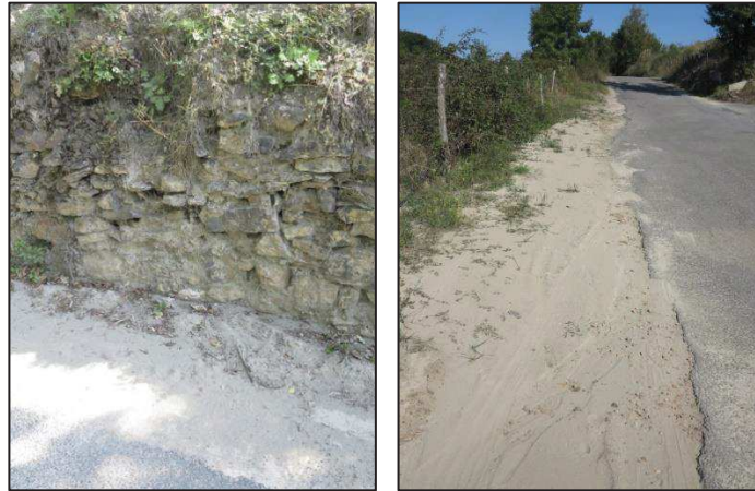
Figure 115 – Vues de l'échappement de résidus vers la Route des Crêtes au travers du mur ouest de la « digue » n°1 (à gauche), de l'entraînement de particules de résidus le long de la Route des Crêtes vers le sud (à droite) (septembre 2018)
