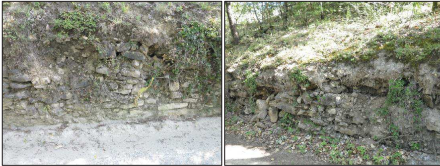
Figure 95 – Vues du mur qui retient les résidus en périphérie ouest de la « digue » n°1, échappement des résidus entre les pierres vers la route des Crêtes
