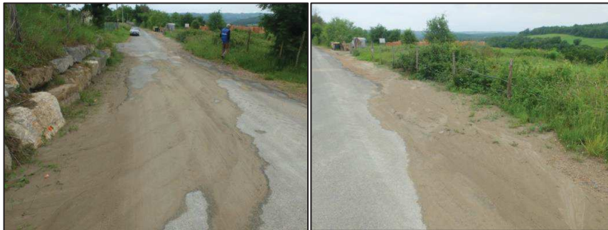
Figure 96 – Entraînement de matériaux de la « digue » n°1 par ruissellement lors de périodes de fortes précipitations sur la route des crêtes - Limite ouest du dépôt (septembre 2018)
