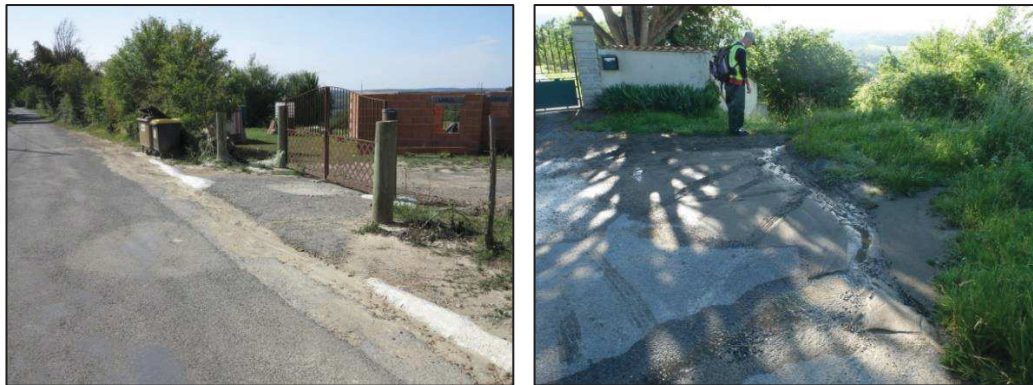
Figure 116 – Vues de l'entraînement de particules de résidus le long de la Route des Crêtes vers le sud (à gauche) (septembre 2018) et du ruissellement de résidus sur la chaussée au sud-est de la « digue » (à droite) (mai 2018)
