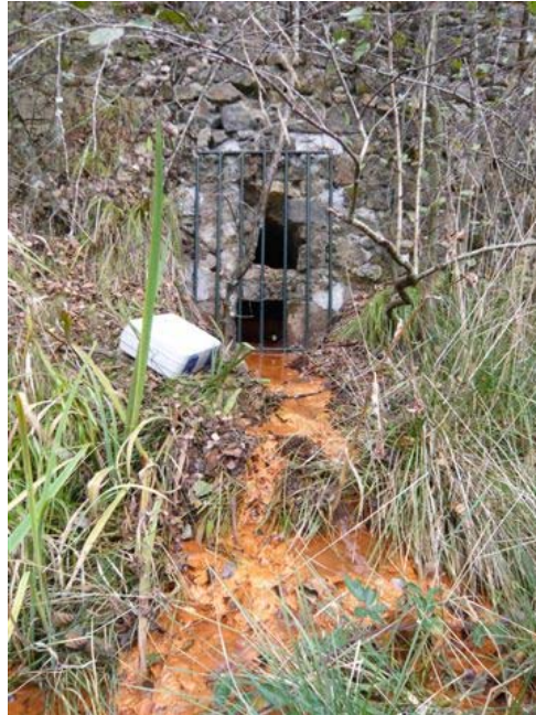
Sortie d'eaux ferrugineuses galerie de Barbecot
