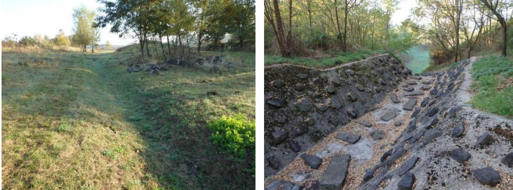
Illustration 51 : Dépôt de Côte Gravelle à Roche-la-Molière (42) - Fossé d'évacuation des eaux pluviales en partie sommitale (à droite) et caniveau rejoignant le bassin d'orage (à gauche).
