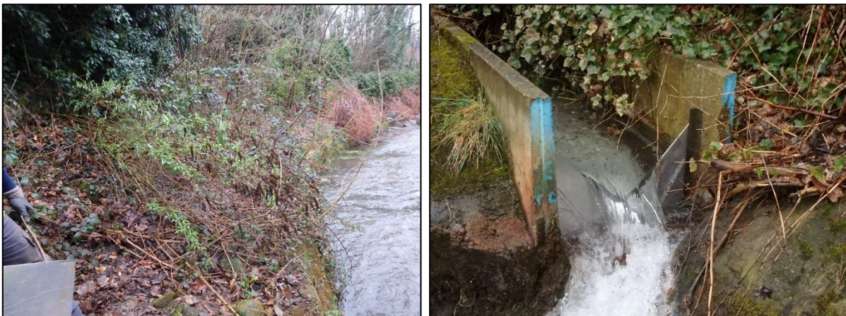
Illustration 21 : Émergence du Bas-Mas à Firminy (42) - Accès difficile au point de rejet des eaux de l'émergence minière du Bas Mas dans l'Ondaine (à gauche) et rejet des eaux minières canalisées avec déversoir triangulaire (à droite).
