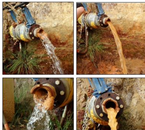
Illustration 65 : Galerie G8 à Soyons (07) - Décolmatage du forage de décharge en novembre 2018 par « chasse » avant (à gauche) et après (à droite).
