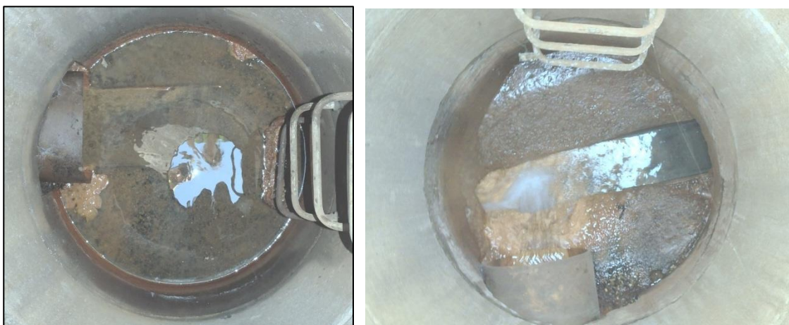
Illustration 23 : Émergence minière de la galerie Roare à Roche-La-Molière (42) - Regard de contrôle pour partie ennoyé par la remontée d'eaux usées (à gauche) et regard de jonction des deux réseaux (à droite).
