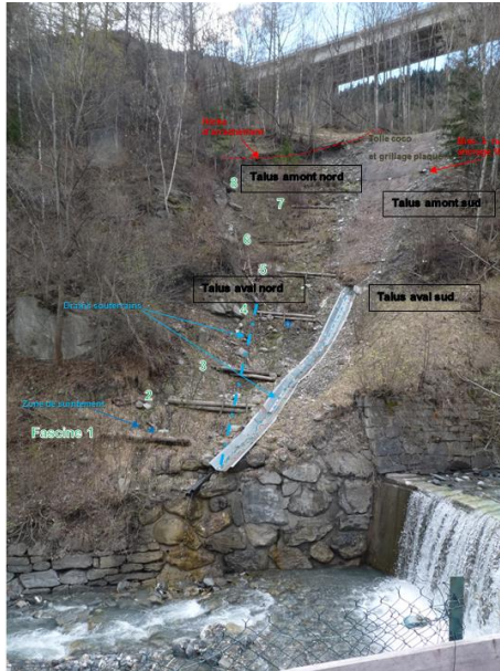
Illustration 86 : Émergence de Côte-en-Velin à Fourneaux (73) - Vue d'ensemble de l'ouvrage depuis la rive gauche du ruisseau du Charmaix.
