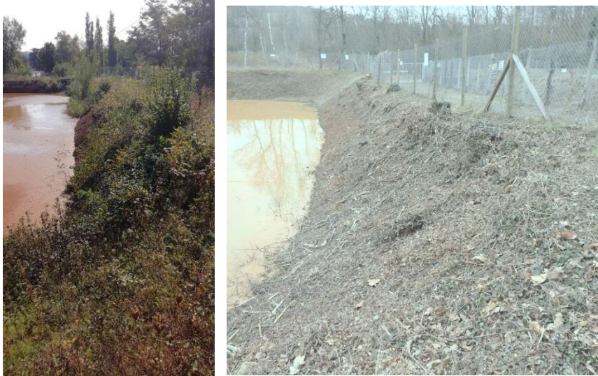
Illustration 81 : Station de traitement des eaux minières de Chessy-les-Mines (69) Berge du Bassin de filtration n° 1 avant (à gauche) et après débroussaillage (à droite).
