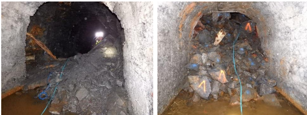
Illustration 90 : Galerie minière du TB Saint-Jacques aux Chapelles (73) – Matériaux meubles alimentant l'éboulis sous la première cloche de fontis (à gauche) et passage étroit vers deuxième fontis obturé par de nouveaux blocs (à droite).
