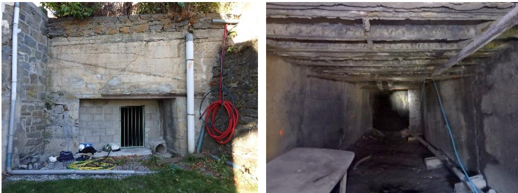
Illustration 89 : Galerie minière du TB Saint-Jacques aux Chapelles (73) - Entrée de la galerie après travaux d'aménagement (à gauche) et toit dégradé de la galerie sous la voie communale (à droite).
