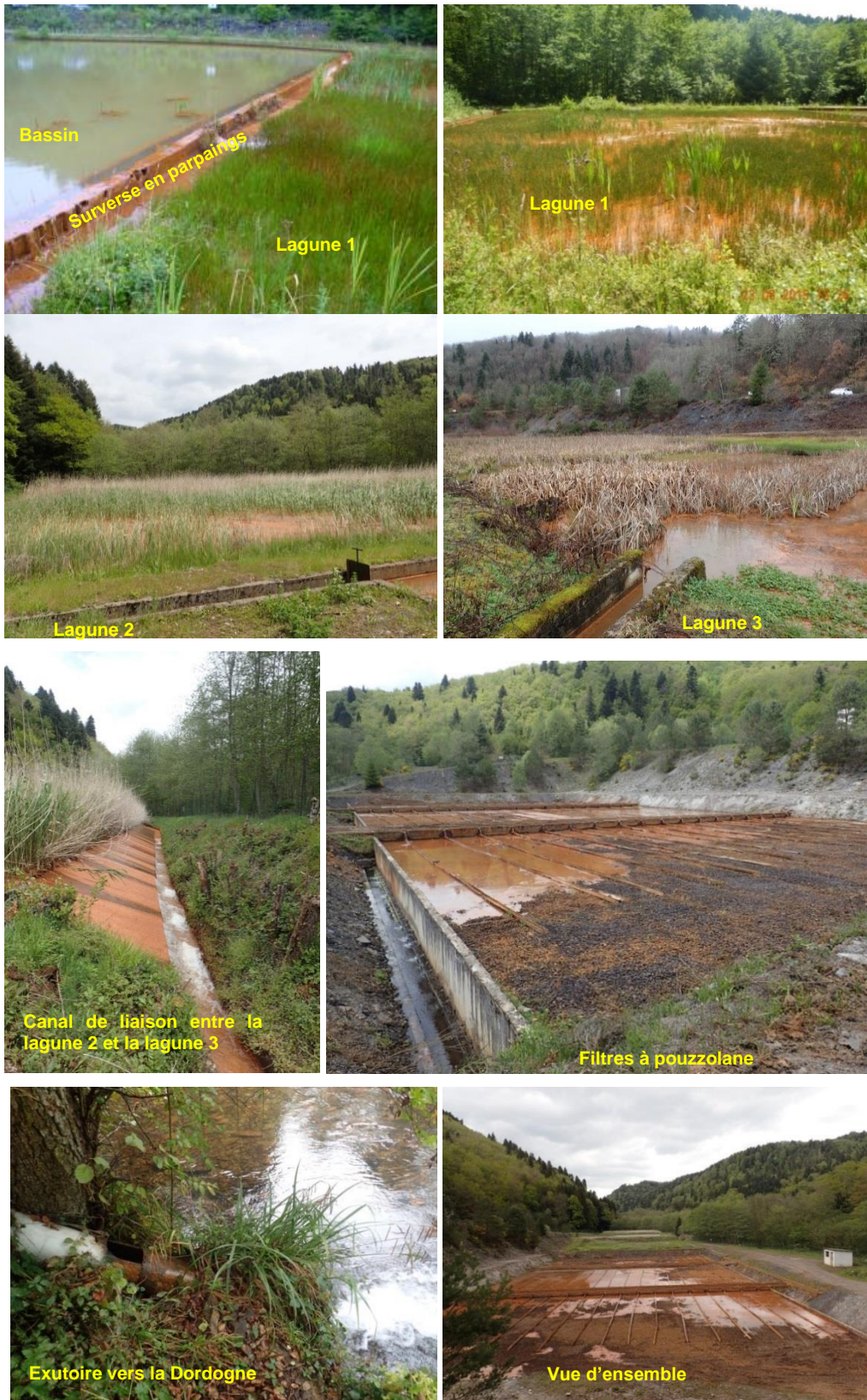
Illustration 120 : Messeix - Les principaux éléments assurant le fonctionnement de la station.
