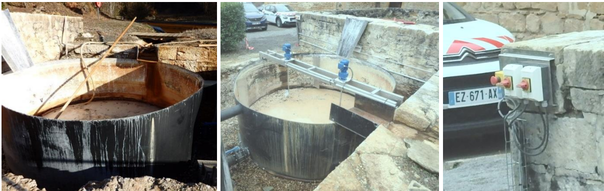
Illustration 82 : Station de traitement des eaux minières de Chessy-les-Mines (69) - Cuve de traitement « de secours » avec l'agitateur manuel (à gauche) et agitateurs automatiques (au centre et à droite).
