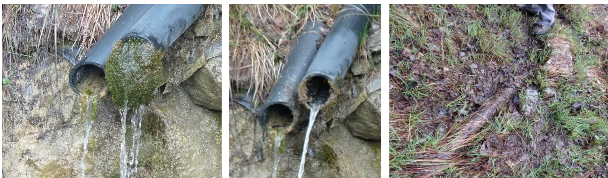
Illustration 87 : Émergence de Côte-en-Velin à Fourneaux (73) – Écoulement des drains avant nettoyage (à gauche) et après (au centre) et suintements d'eau au niveau de la fascine 1 (à droite).
