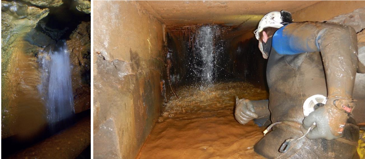
Illustration 57 : Galerie minière sous usine Aubert et Duval à Firminy (42) - Venues d'eaux minières en fond de galerie (à gauche) et d'eaux provenant d'une pompe de vidange de l'usine par plafond (à droite).
