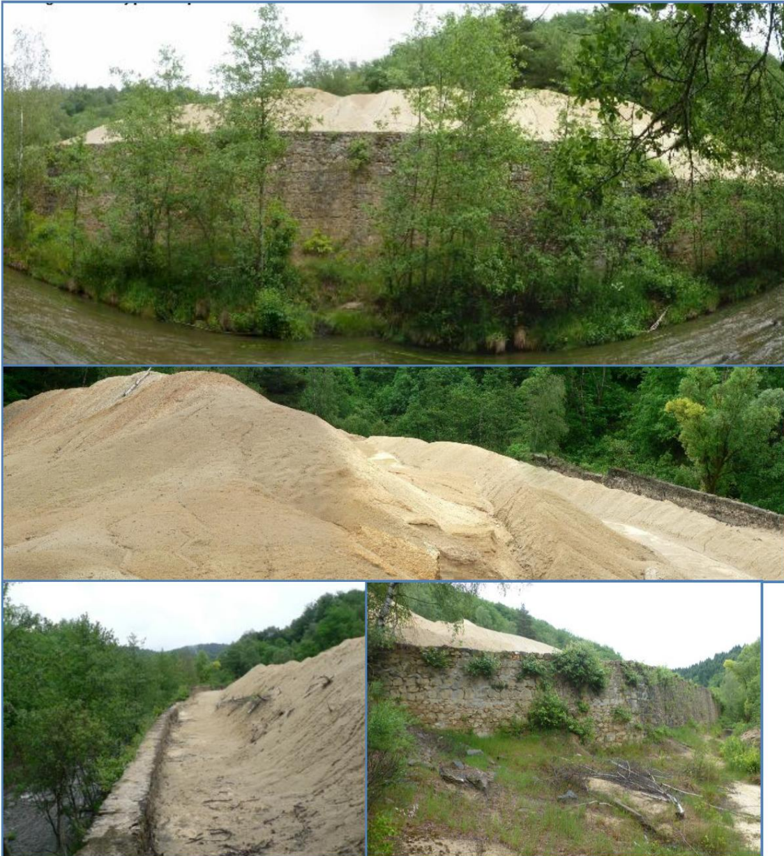
Illustration 138 : Vues du dépôt de Barbecot et du mur de soutien (Source : ANTEA 2013).
