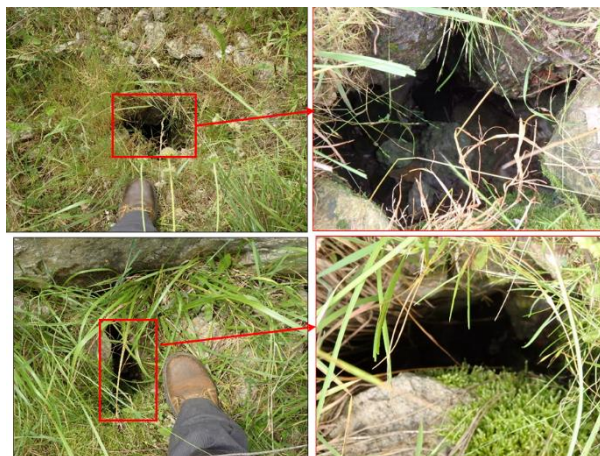
Illustration 54 : Dépôt de Côte Gravelle à Roche-la-Molière (42) - Trous observés sur le plateau au pied de l'ancienne zone d'éboulement du talus nord-ouest.
