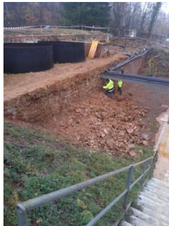
Illustration 80 : Station de traitement des eaux minières de Chessy-les-Mines (69) - Partie supérieure du mur démolie.
