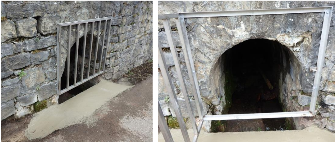
Illustration 18 : Émergence minière de la galerie Psychagnard à Susville (38) - Portillon de fermeture de la galerie d'accès au point de contrôle de l'émergence.
