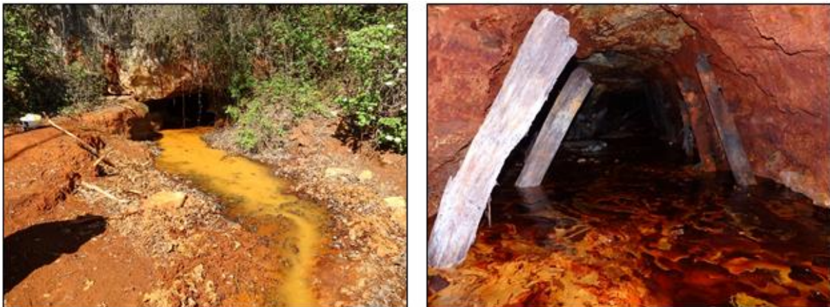
Illustration 67 : Galerie G10 à Soyons - Vue de la galerie G10 en 2018, entrée (à gauche) et intérieur (à droite).
