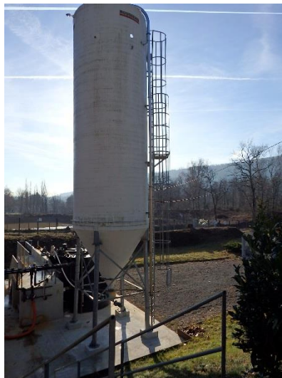
Illustration 78 : Station de traitement des eaux minières de Chessy-les-Mines (69) - Vue de l'unité de chaulage.
