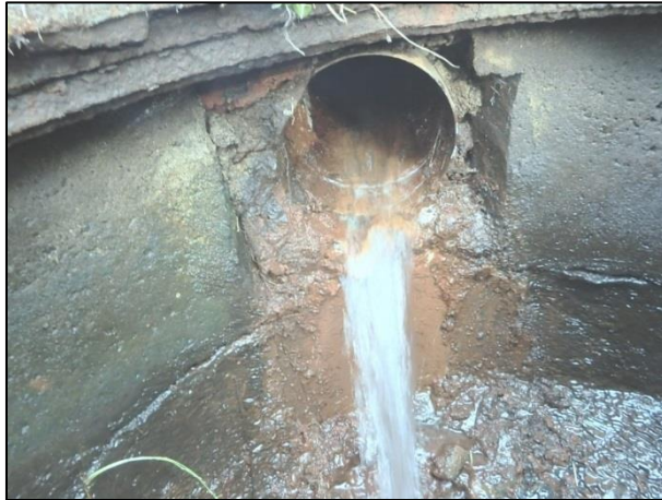
Illustration 22 : Émergence minière de la galerie du Bas de Cluzel à Saint-Genest-Lerpt (42) - Canalisation en fond de regard de visite très peu encroûtée.
