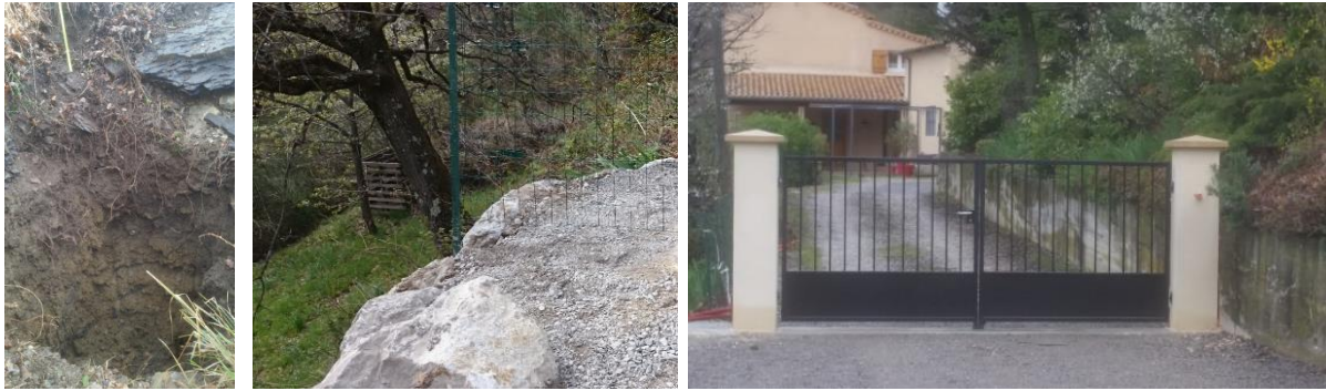
Illustration 69 : Travaux de mise en sécurité d'un fontis et réfection d'un portail à Veyras (07) – Nettoyage du fontis (à gauche) enrochement de la butte (au centre) et nouveau portail (à droite).
