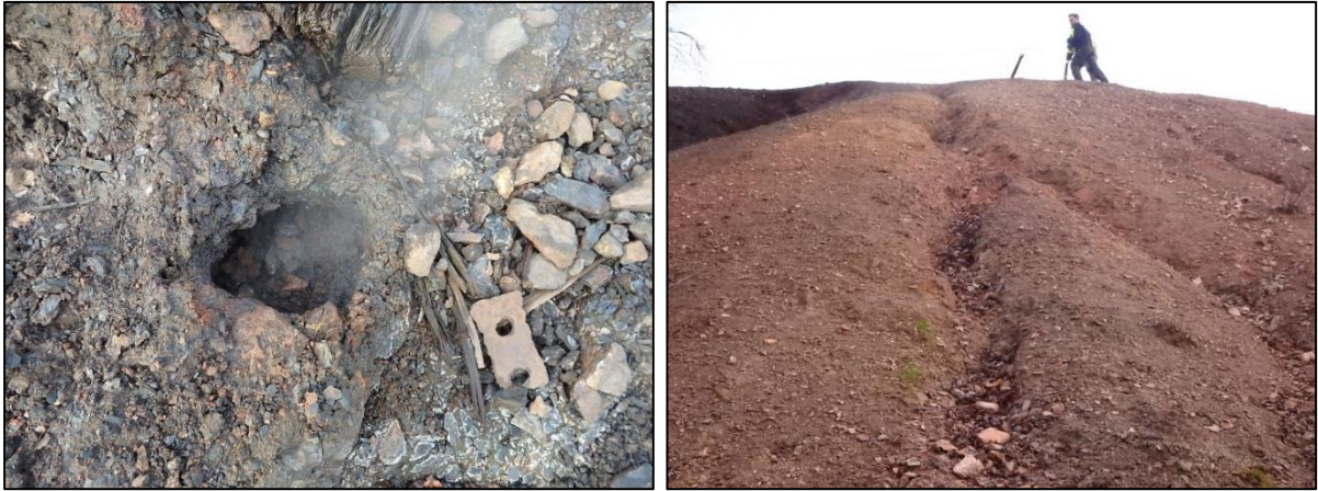
Illustration 36 : Terril Couriot A à Saint-Étienne (42) - Crevasse due aux échauffements souterrains (à gauche) et petite ravine au niveau du rampant (à droite).
