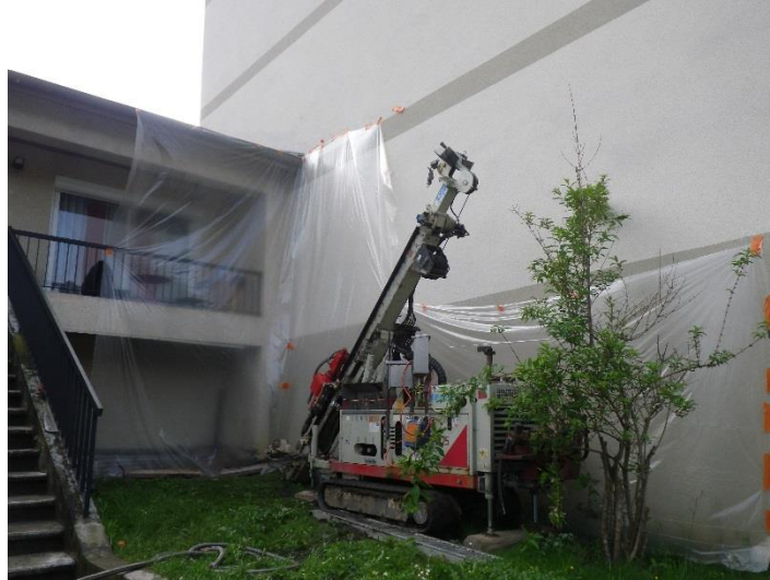
Illustration 58 : Mise en sécurité d'une habitation à Villars (42) – Atelier de sondage lors des travaux de reconnaissance des vides souterrains.
