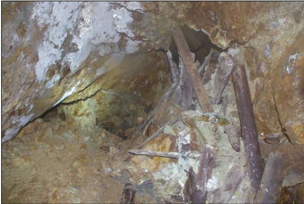
Figure 24 : Vue de travaux éboulés (recherche 1923 - Le Mas)
