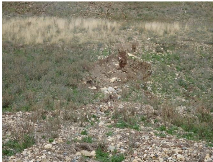
Illustration 66 : Ravinement dans le flanc ouest de Montredon après intempéries d'octobre 2018 - Salsigne (11).
