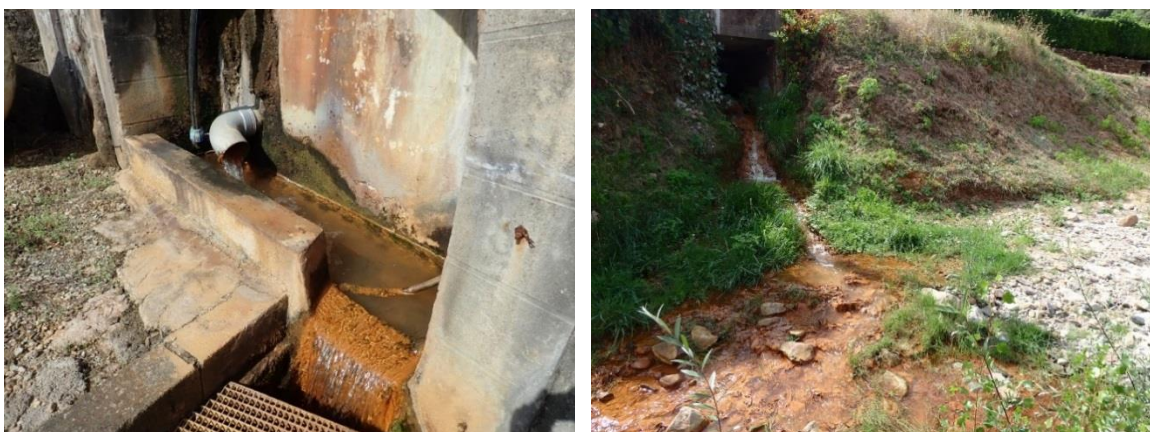
Illustration 42 : TB Frangouille - à gauche : rejet dans le canal d'évacuation, à droite rejet dans le milieu naturel récepteur - La Tour-sur-Orb (34).
