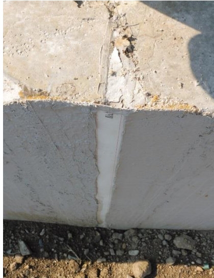
Illustration 16 : Station de Destival – Reprise d'un joint de la lagune n° 3 - Saint-Martin-de-Valgalgues (30).
