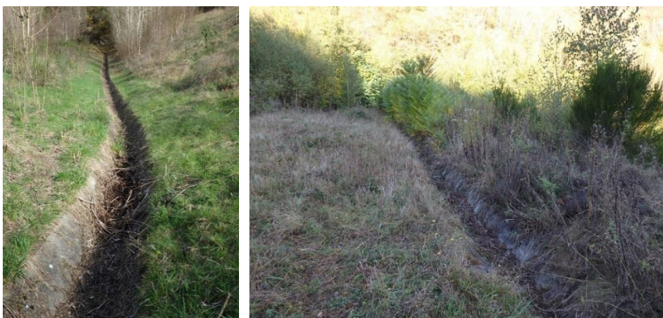
Illustration 114 : Dépôt de Joany à Viviez (12) - Réseau hydraulique superficiel encombré de dépôts terreux et de débris végétaux en avril (à gauche) et en octobre (à droite).
