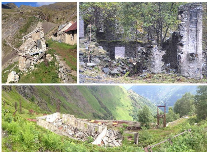
Illustration 132 : Sentein (09) : anciens bâtiments menaçant ruine à démolir à Bentaillou (en haut à gauche), au Départ d'Urets (en haut à droite) et sur la plateforme de Rouge (en bas).
