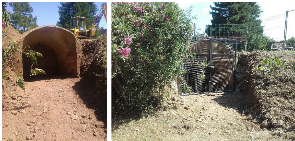
Illustration 38 : Saint-Julien : à gauche : vue de l'entrée de la descenderie désobstruée – à droite : portail provisoire de fermeture - Saint-Paulet-de-Caisson (30).
