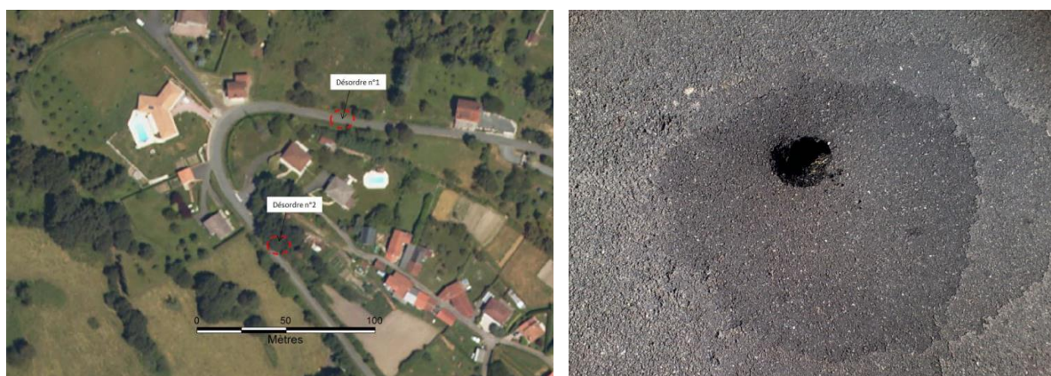
Illustration 117 : Fontis sous la RD 513 au lieu-dit « la Gouzinie » à Aubin (12) - Localisation des désordres n° 1 et n° 2 (à gauche) et reouverture en juillet 2018 du désordre n° 1 rebouché par le CD 12 à plusieurs reprises (à droite).
