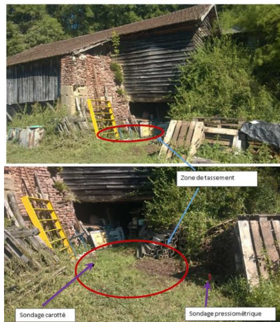
Illustration 119 : Ancien puits de mine Sainte-Geneviève à Auzits (12) - Localisation de la zone de tassement (en haut) implantation des sondages carotté et pressiométrique (en bas).
