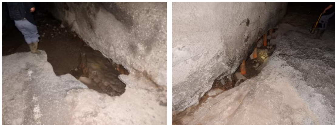
Illustration 33 : Ruisseau couvert Lascous - Exemple de dégradation du radier (à gauche) et en base de piedroits (à droite) - Laval-Pradel (30).
