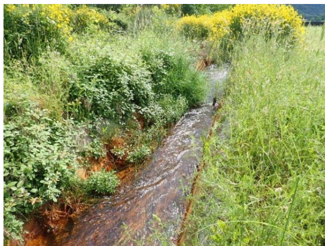
Illustration 46 : TB 250 - Invasion de la végétation au niveau du canal d'évacuation - Le Bousquet-d'Orb (34).
