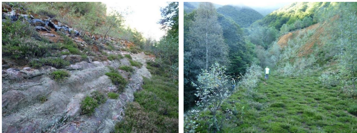
Illustration 127 : Ancienne mine de tungstène de Salau (09) : digue du bassin n° 1 en pied de la versé 1230 avec sacs endommagés (à gauche) et végétation recouvrant le bassin (à droite).
