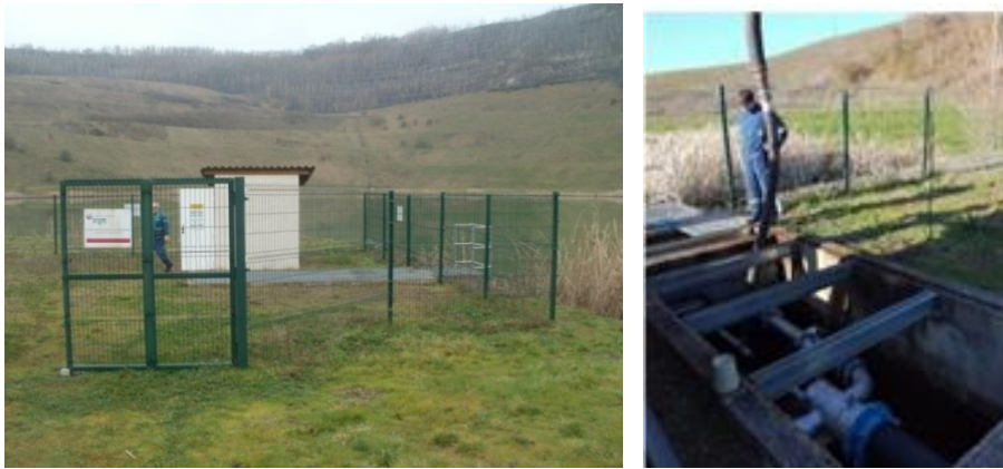
Illustration 95 : Station de pompage du lac Lassalle à Decazeville (12) – enclos avec local technique (à gauche) et ouvrage de collecte des eaux avec groupe de pompage (à droite).
