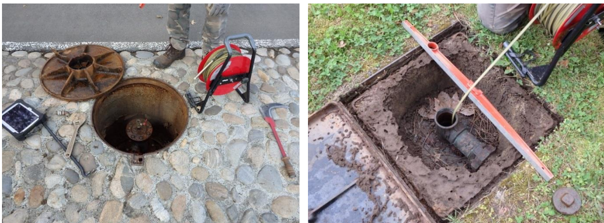
Illustration 90 : Sondage de décompression Treille-Haute 1 et Puits de mine P1 Ancien à Cransac – Mesure piézométrique du réservoir minier du Banel dans les ouvrages Treille Haute 1 (à gauche) et puits P1 Ancien (à droite).
