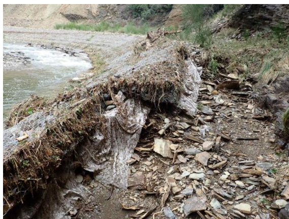
Illustration 62 : Site de Nartau – Gabions endommagés en partie terminale par la crue d'octobre - Villanière (11).
