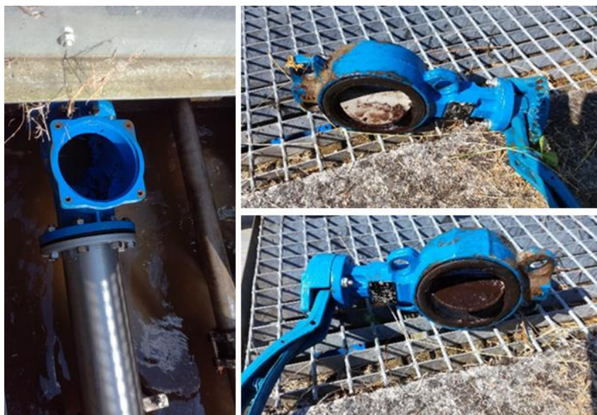
Illustration 96 : Station de pompage du lac Lassalle à Decazeville (12) – Nettoyage des dépôts au niveau des clapets anti-retour.
