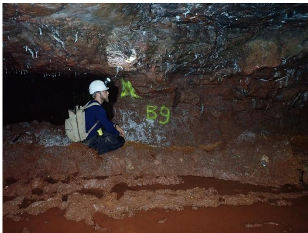
Illustration 135 : Quartier Espeyroux à Muret-le-Château (12) – Flaques d'eau à proximité du pilier B9.
