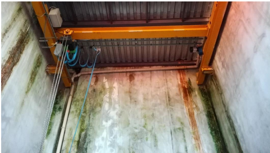
Illustration 10 : Puits Fontanes à Saint-Martin-de-Valgalgues (30) - Vue des traces de suintement provenant du plafond du local.
