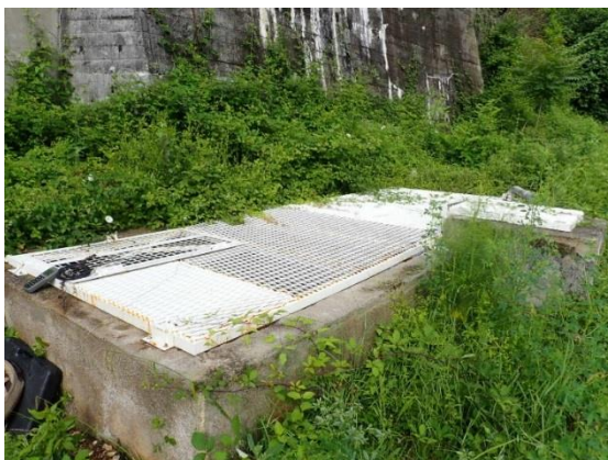
Illustration 22 : Émergence Silhol : grille recouvrant le bassin récepteur aménagée avec une trappe d'accès – Molière-sur-Cèze (30).
