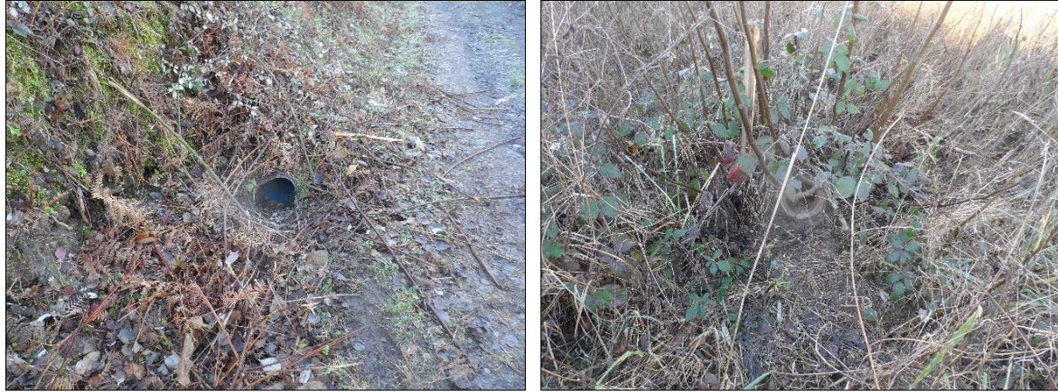
Illustration 107 : Terril Lacaze à Decazeville - Buse de collecte au sommet d'une banquette (à gauche) et fossé aérien partiellement obstrué au pied du talus (à droite).
