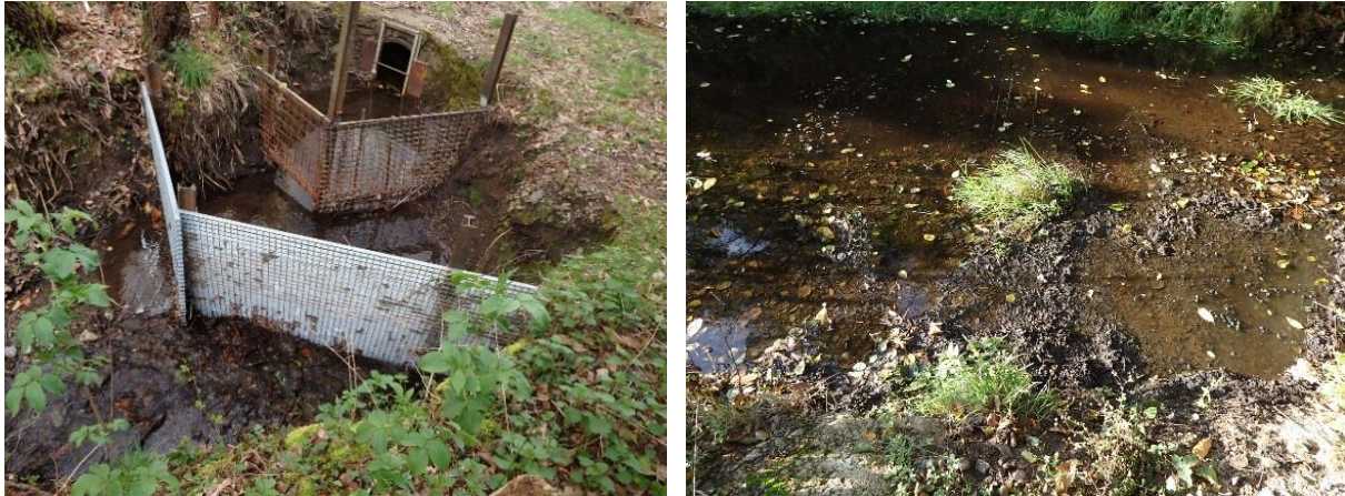
Illustration 113 : Dépôt de Joany à Viviez (12) - Pièges à embâcle sans dégrilleur du Vallon du Coupel (à gauche) dépôt de sédiment dans le bassin réception des eaux (à droite).
