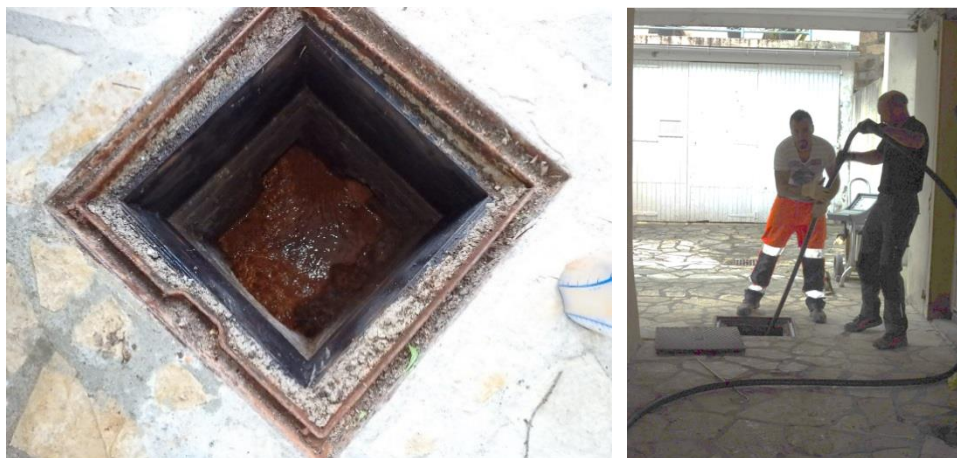
Illustration 86 : Émergences minières du bassin houiller de l'Aveyron (12) - Hydrocurage de l'émergence minière Fontvernhe : regard R4 (à gauche) et nettoyage au furet hydrocureur (à droite).
