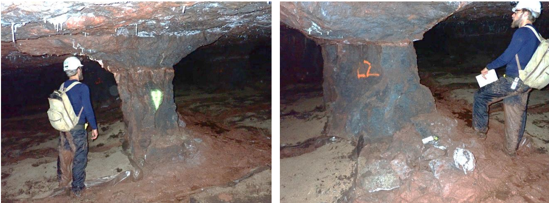
Illustration 134 : Quartier Espeyroux à Muret-le-Château (12) - Cliché photographique des piliers dégradés A14 (à gauche) et A15 (à droite) localisés au Nord sous l'enjeu n° 1.
