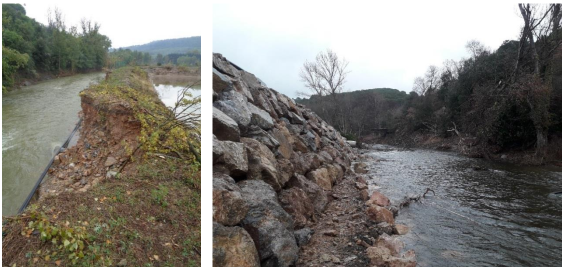
Illustration 75 : Digue de la lagune d'infiltration suite à la crue d'octobre 2018 – à gauche : avant réparation – à droite : après renforcement - Limousis (11).
