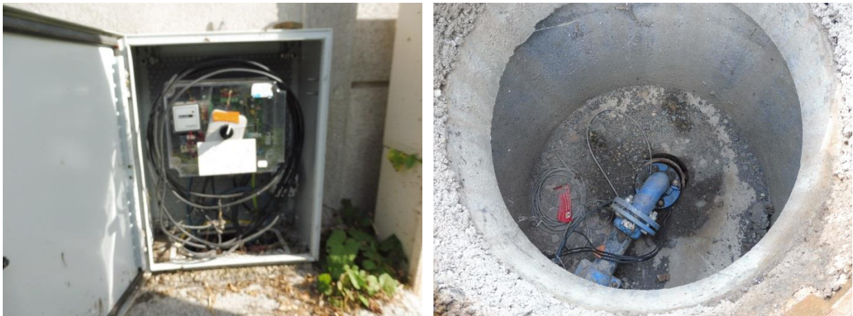
Illustration 87 : Forage de rabattement Vialarels 2/170 à Decazeville (12) – armoire de commande du forage adossée à un bâtiment (à gauche) et tête de forage (à droite).
