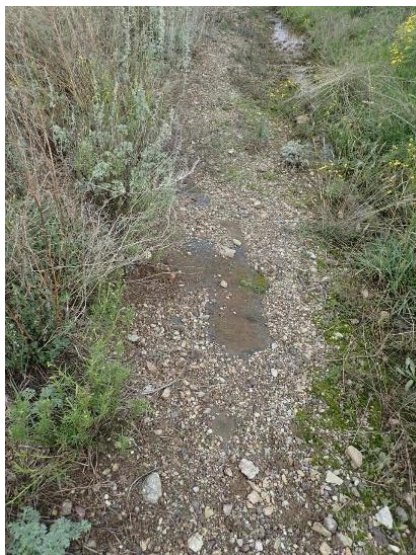
Illustration 80 : Fossé avec membrane d'étanchéité localement à nu, en tête de la verse de San-Culgat - Escaro (66).
