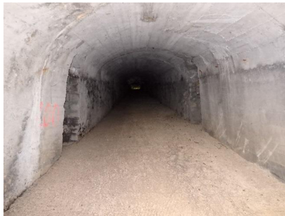
Illustration 31 : Plan Incliné des Oules : état plutôt correct de la galerie - Commune de Laval-Pardel (30).
