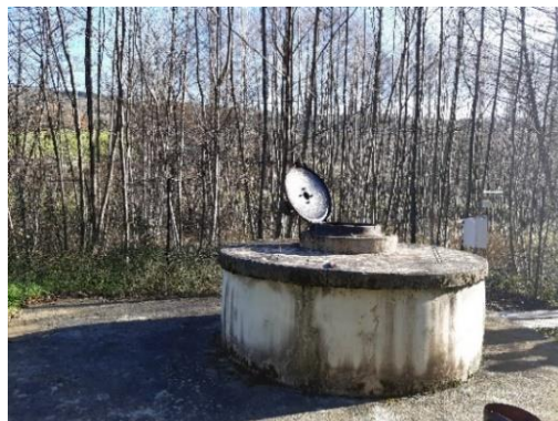
Source de Peyrolle Captage principal et déversement du trop-plein associé
